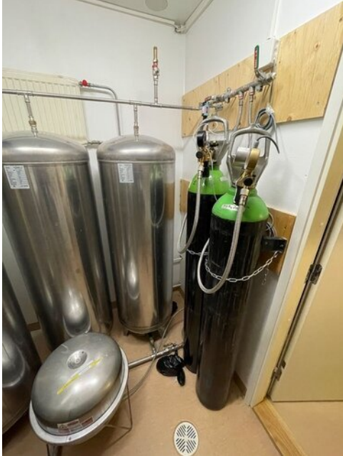
Kiinteistössä on palonsammutusjärjestelmä. Toiminnan varmistamiseksi sammutusvesi varastoidaan 6 x 300l säiliöihin, jossa on 10bar paine.
