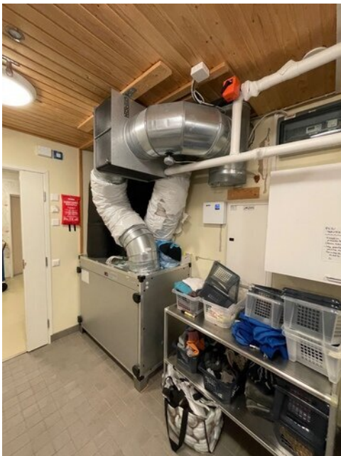
Ilmanvaihtokone ei ole erillisessä tilassa vaan on sijoitettu nurkkaan, jonka kautta asiakkaat kulkevat saunaosastolle
